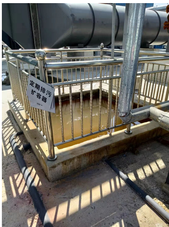
图 4-4 瓦斯氧化炉余热锅炉定期排污水储水池
