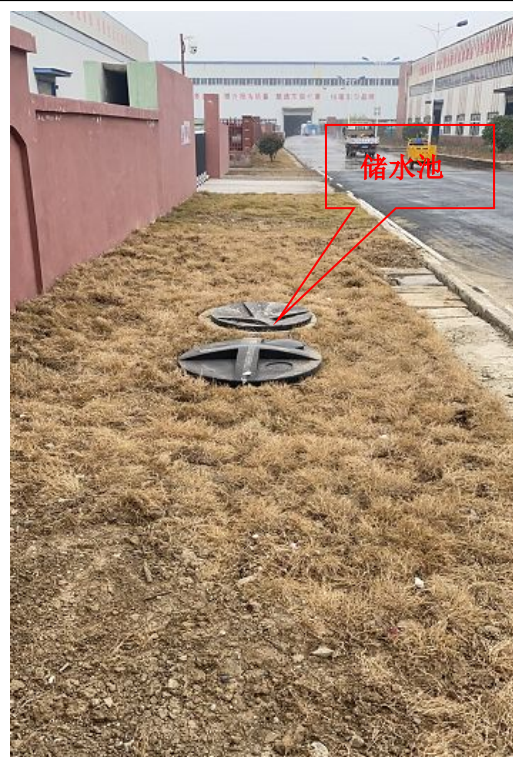
图 4-5 瓦斯氧化炉余热锅炉软水制备废水储水池
