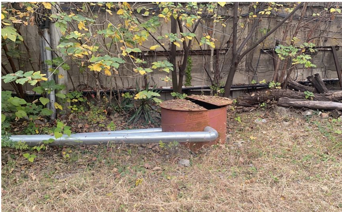
图 4-6 瓦斯发电机组区域余热锅炉定期排污水储水池
