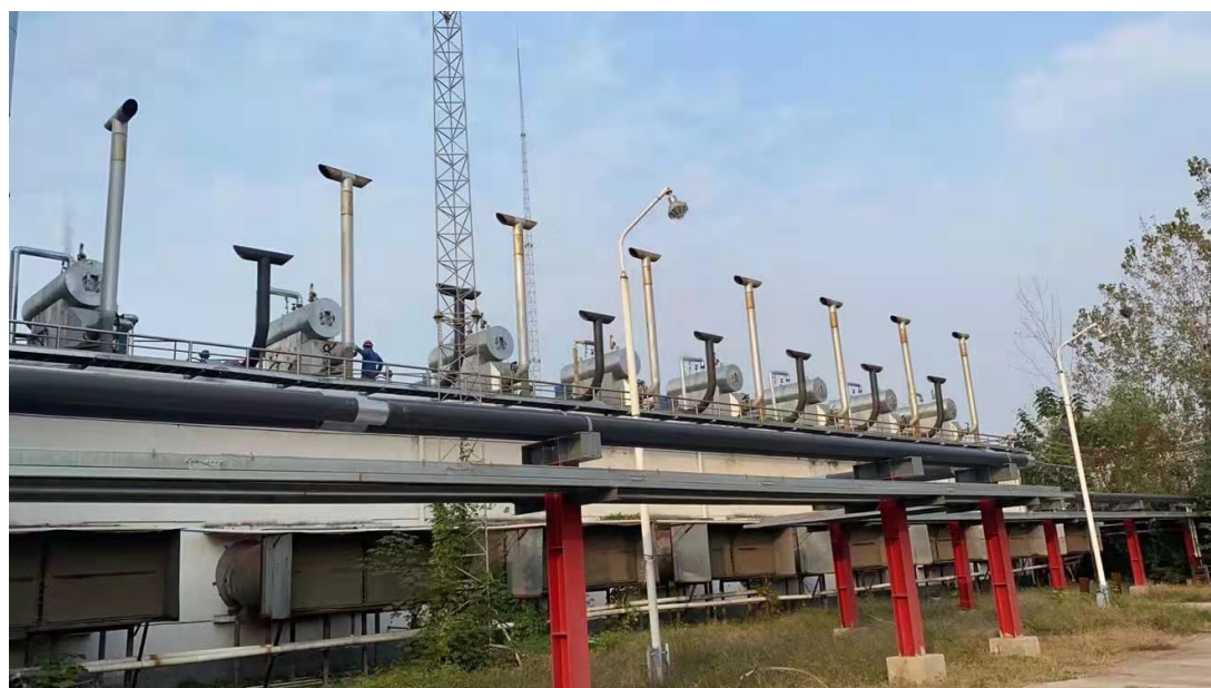
图 4-9 瓦斯发电配套余热锅炉排气筒
