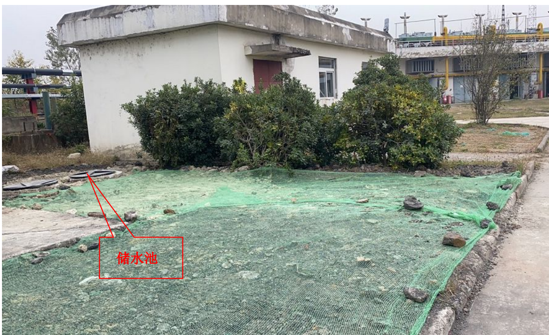
图 4-7 瓦斯发电机组区域余热锅炉软水制备废水储水池
